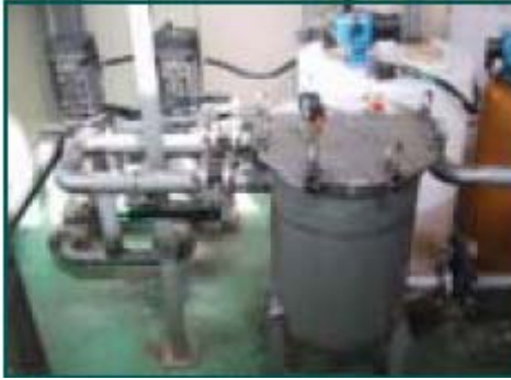
Filtro Bolso, Bombas Alimentación, & Bombas Medición Químicas limpiadores
